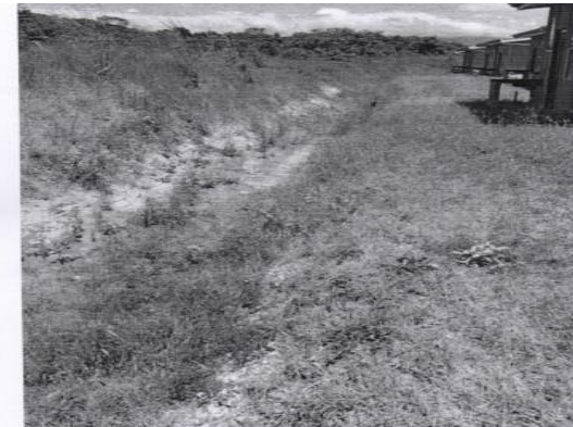
Canal en tierra ( se solicita el revestimiento del mismo para evitar la sedimentación además de separarlo de las viviendas junto con la instalación de una malla perimetral).
